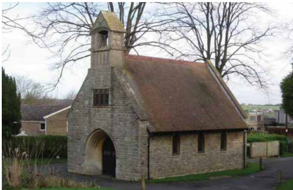
4. Capela mortuară Headington, Oxford – fotografie din anul 2012, în care se pot vedea deteriorările de pe arcada de piatră de la accesul în clădire.
