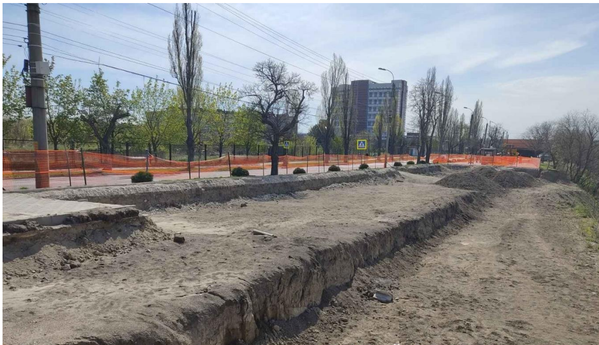
Рисунок 1. Оползневые смещения на смотровой площадке, ул. М. Драган, мун. Кишинэу, 2022 (фото Н. Иким)
